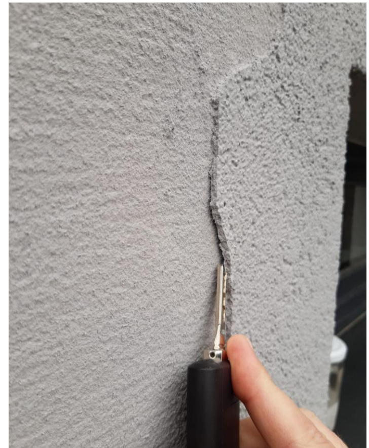
Zmrzlá povrchová úprava
