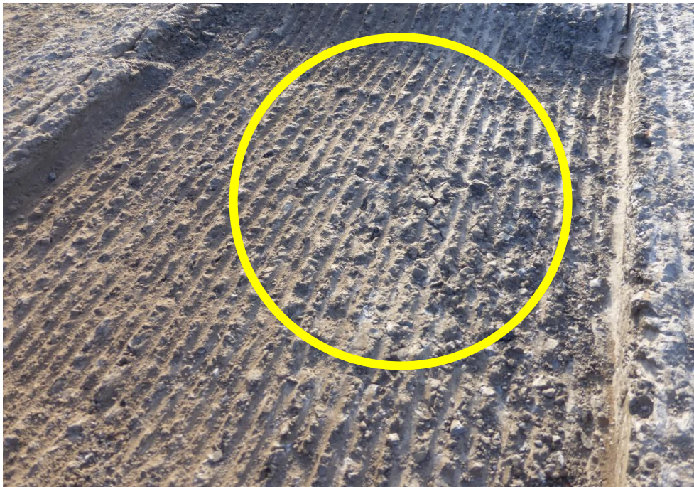
Obr.č.6 Porucha na mostě. Boule na ohrusné vrstvě. Zdroj: Plachý,Horsky 2012
