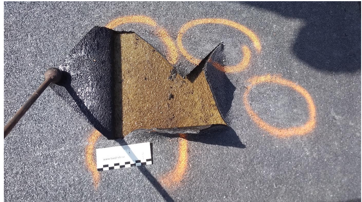
Obr.č.7 Porucha na mostě. Boule na hydroizolační vrstvě. Zdroj: vlastní.
