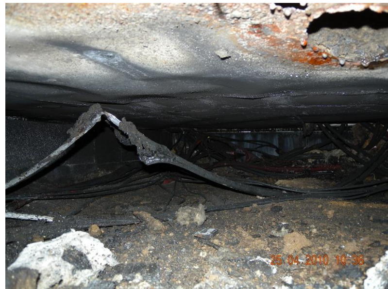
Zkratové účinky kabelového vedení na spodní část kontejneru
