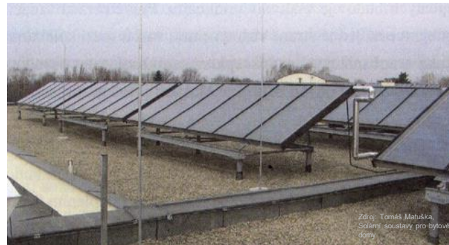
Mechanicky ukotvené FVE
