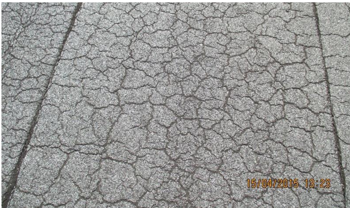
Obr. č. 7 – Celkový pohled na asfaltový modifikovaný pás pokrytý hlubokým krokodýlingem
