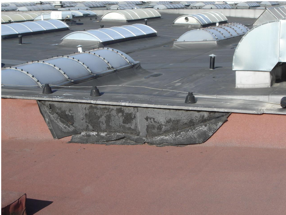
Obr. č. 3 – Sjetá, resp. odpadlá hydroizolace při absenci mechanického kotvení
