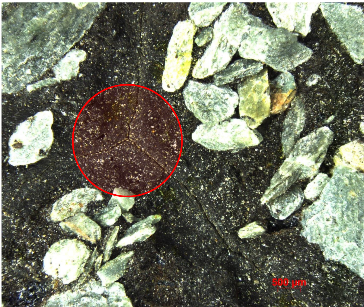
Obr. č. 14 - Mikrofotografie povrchu hydroizolačního materiálu s povrchovým poškozením materiálu, včetně rozestupujícího se kameniva – ochranného hydrofobizovaného posypu
