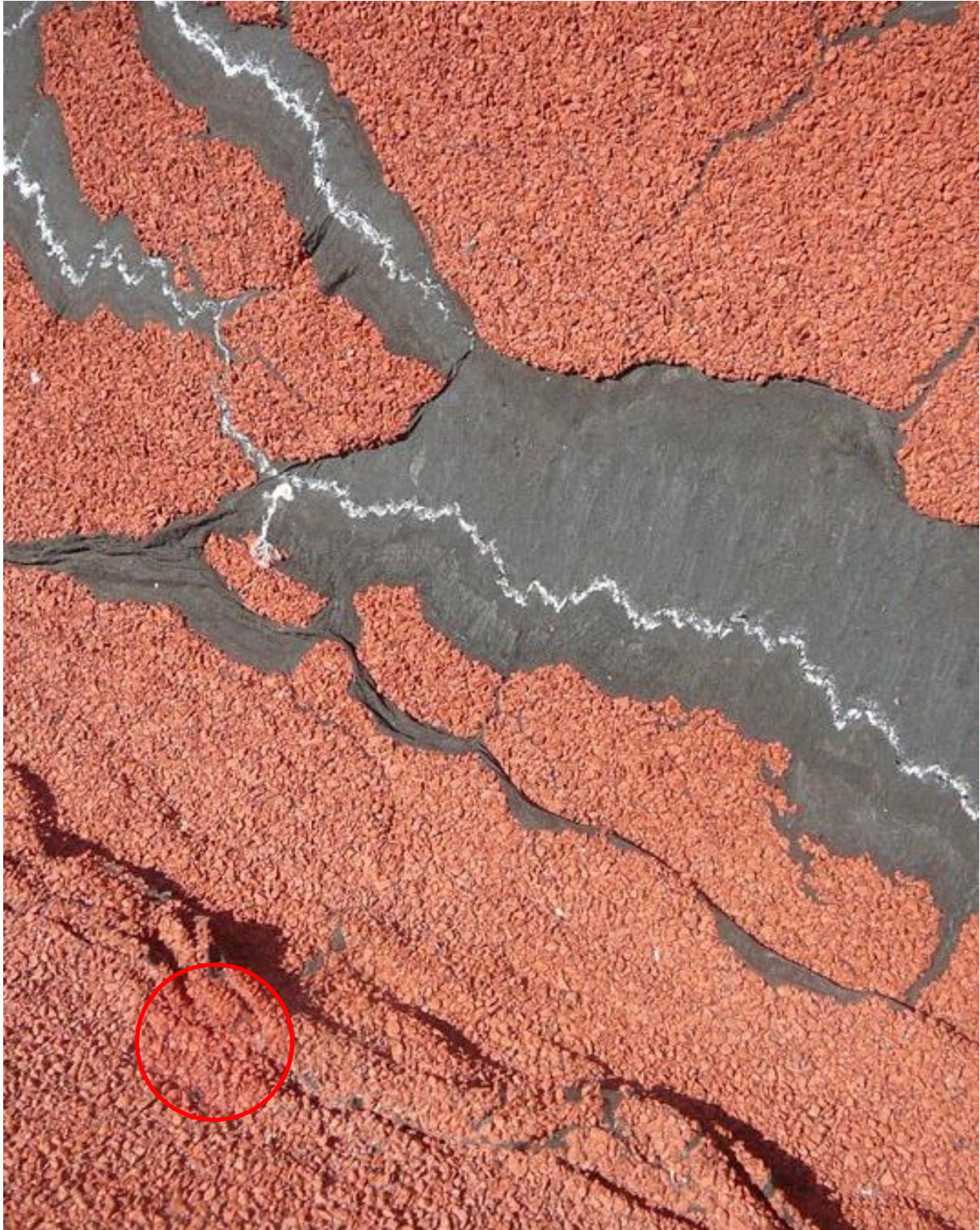
Obr. č. 6 – Sjetá (steklá) vrchní vrstva asfaltu (není vidět výztužná vrstva asfaltu, tedy dominantní problém je s teplotní odolností vrchní vrstvy asfaltu)
