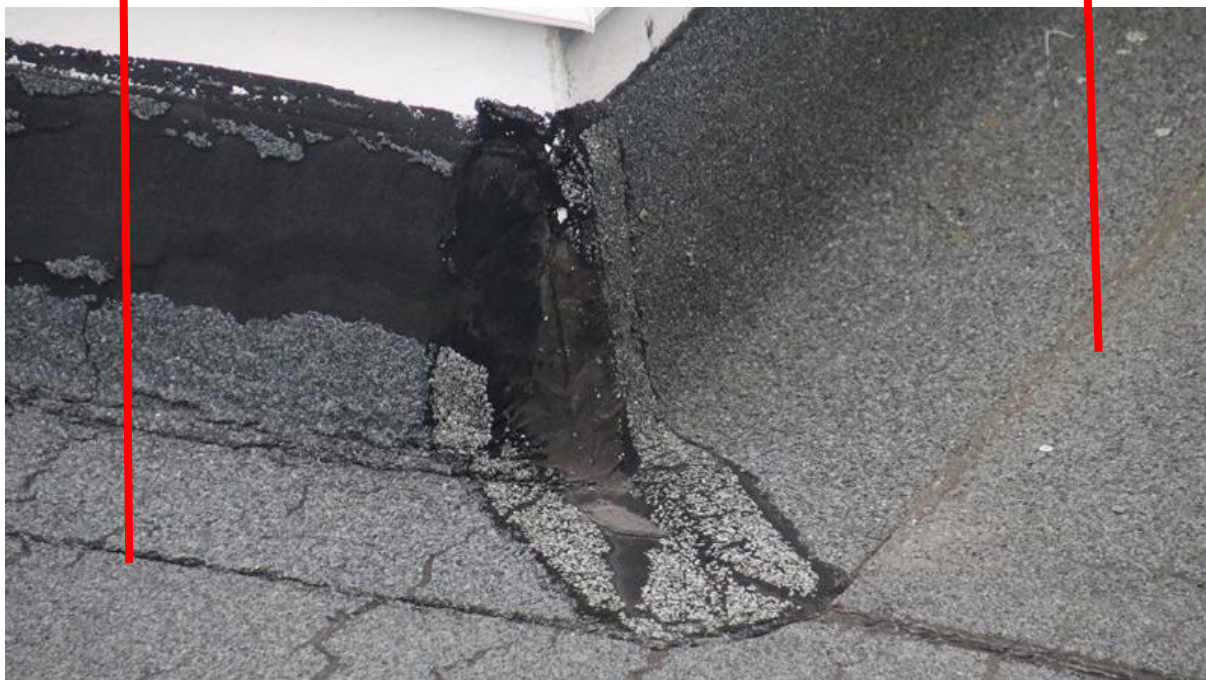
Obr. č. 5 – Krokodýling kombinovaný se stékáním asfaltového hydroizolačního materiálu z konstrukčního detailu (vytažení na světlík) – sjetí vrchní asfaltové hmoty po penetraci výztužné vložky
