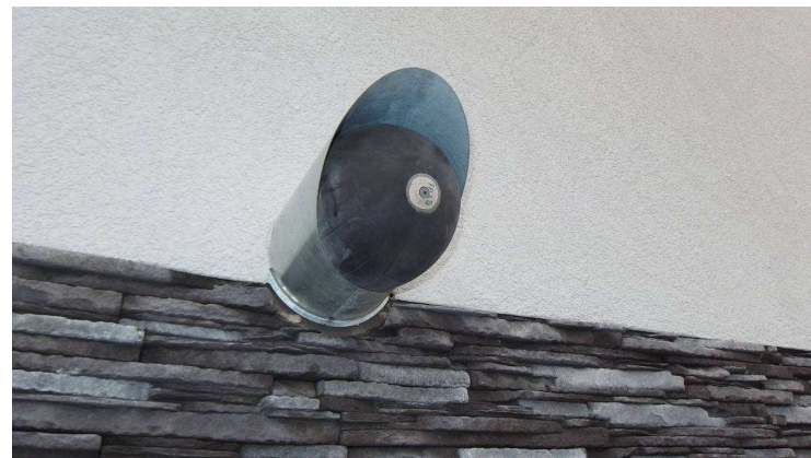
nafukovací balónek v odtahovém potrubí
